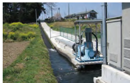
城原井路小水力発電所
