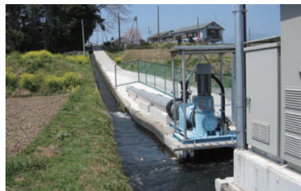
城原井路小水力発電所
